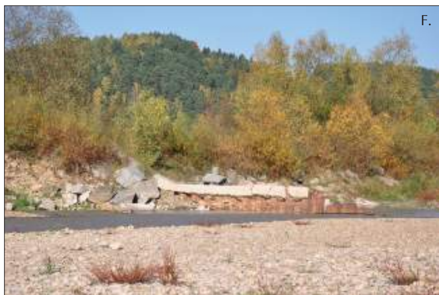
Fot. 5. Zniszczone budowle regulacyjne w korycie Raby (2015); A, B, C – zniszczone opaski, odc. 4, 8, 13, D – zniszczona tama podłużna, odc. 11, E – zniszczone ostrogi (poprzeczki), odc. 9, F – zniszczony stopień, odc. 14
