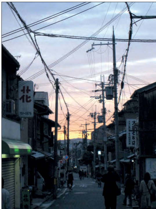
Fot. 15. Typowy sposób prowadzenia kabli elektrycznych (fot. autor)
